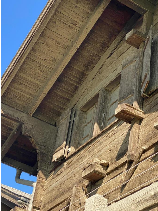
Abb.7 Ansicht einer betroffenen Fassade
