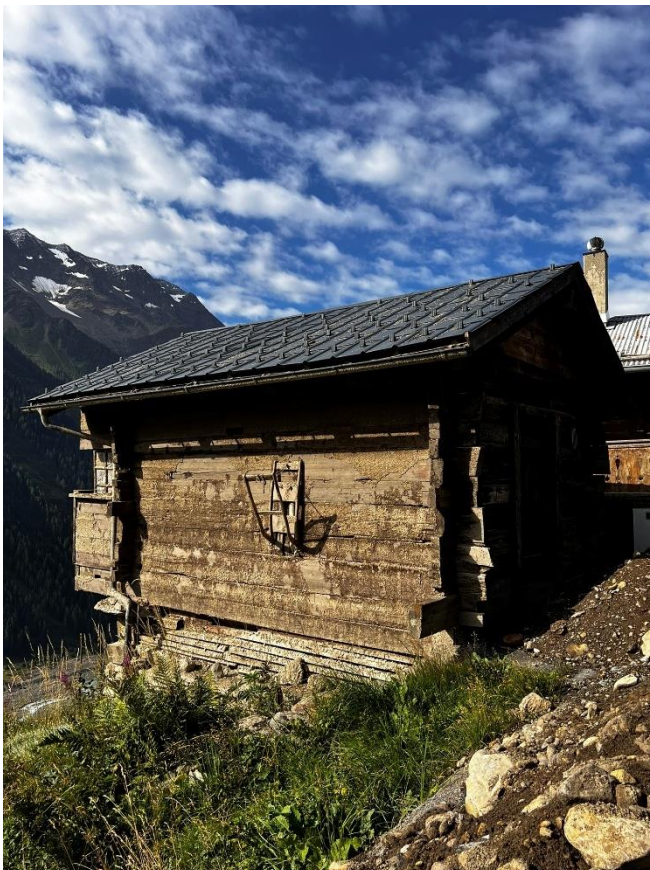
Abb.6 Ansicht einer betroffenen Fassade
