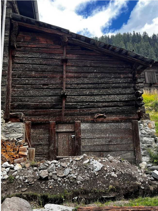
Abb.4 Ansicht einer betroffenen Fassade
