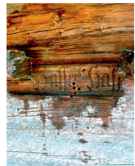
Schadensbild (unten) und gereinigter Fassadenteil. Bild: zvg
