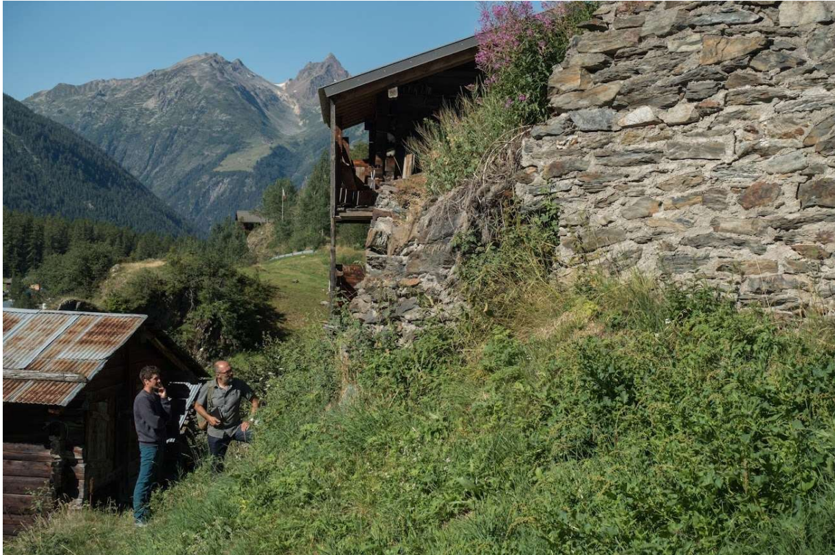
Der westliche Teil der Mauer kurz vor dem Übergang in den mittleren Teil. Die Krone fehlt hier bereits weitgehend.
